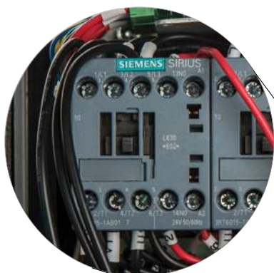
Sistema operativo SIEMENS / SIEMENS relays
